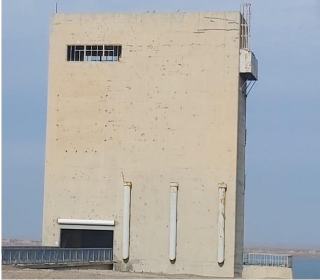
الصورة (2) نفق الطاقة
